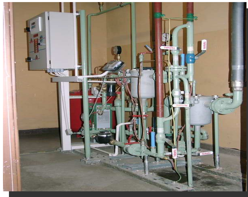
Kotłownia wyposażona w węzeł ciepły
